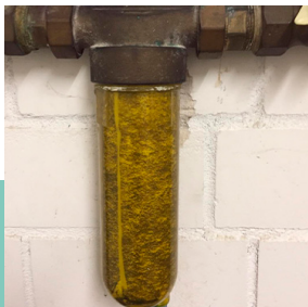
Rückspülfilter im Keller
